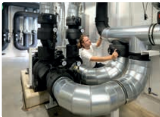
Die neue Kälteanlage am Standort Küchwald ist wartungsarm. Nur hin und wieder muss ein Techniker – wie hier zu Beginn der Inbetriebnahme – nach dem Rechten sehen. Foto: Sebastian Willnow
