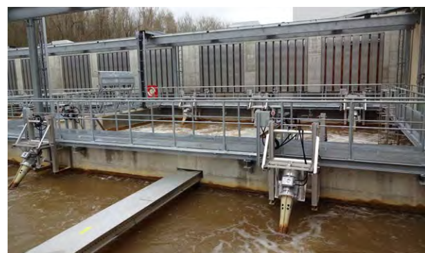
Grubenwasserreinigungsanlage am Tagebau Profen 2018
