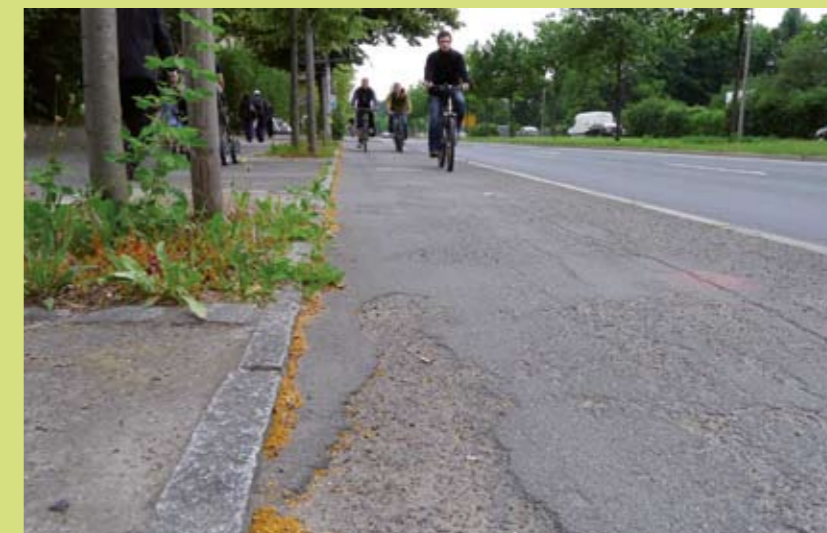
Immer noch nicht saniert: die maroden Radwege am Zelleschen Weg. Foto: Konrad Krause
