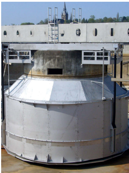
Das zentrale Einlaufbauwerk im Nachklärbecken sorgt für eine effizientere Wasserreinigung.
