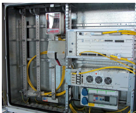
Ein Multifunktionsgehäuse der Telekom; es stammt aus dem ersten Breitband-Ausbauprojekt des Landkreises Bautzen.
