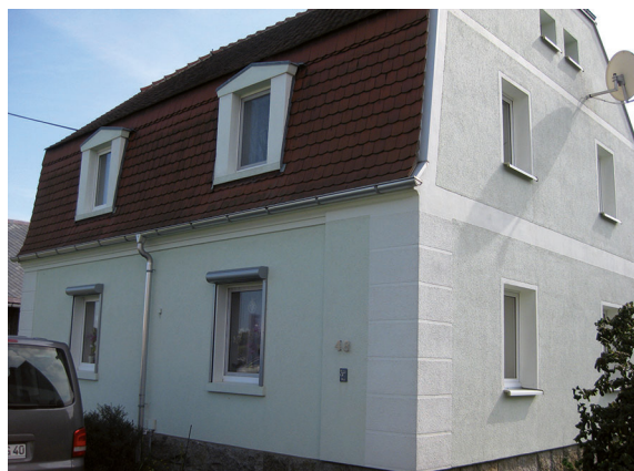
In diesem Haus in Lawalde bei Oppach nervten feuchte Wände, muffiger Geruch und Schimmel. Die Eigentümer probierten einiges ... Den „Durchbruch“ aber brachte erst eine kleine patentierte Anlage.
