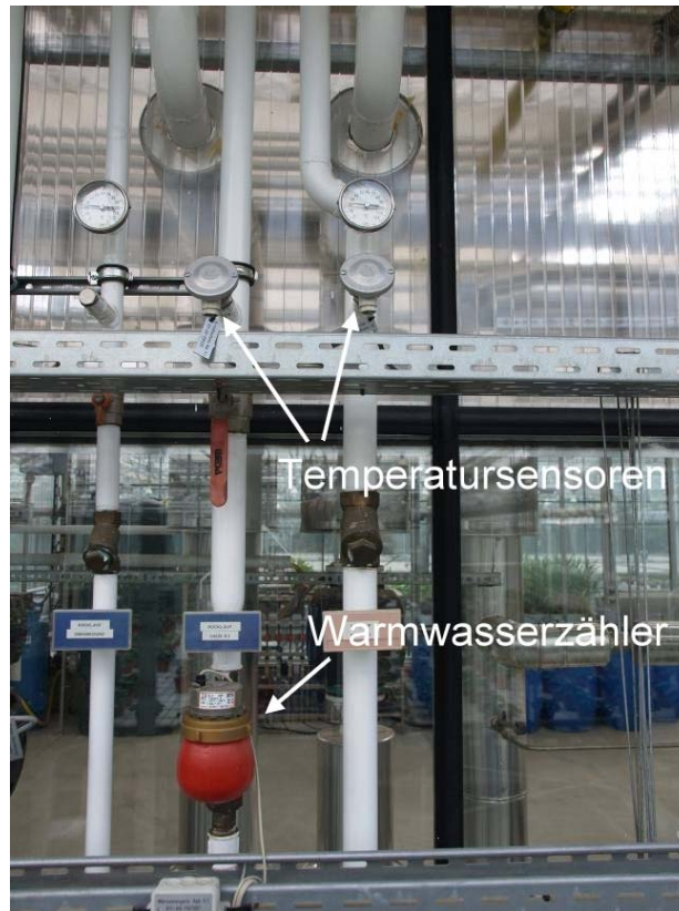
Abbildung 3: Technik für die Wärmeverbrauchsmessungen in den Gewächshausabteilen
