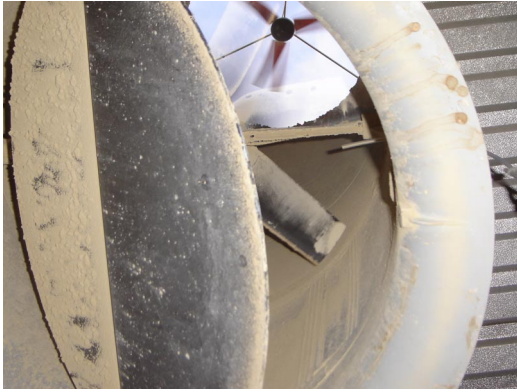
Abb. 11: Messventilator- und Gasmessposition Dachlüfter
