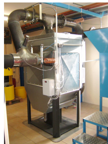
Abbildung 24: Gewebefilter [A.P. Bioenergietechnik]
