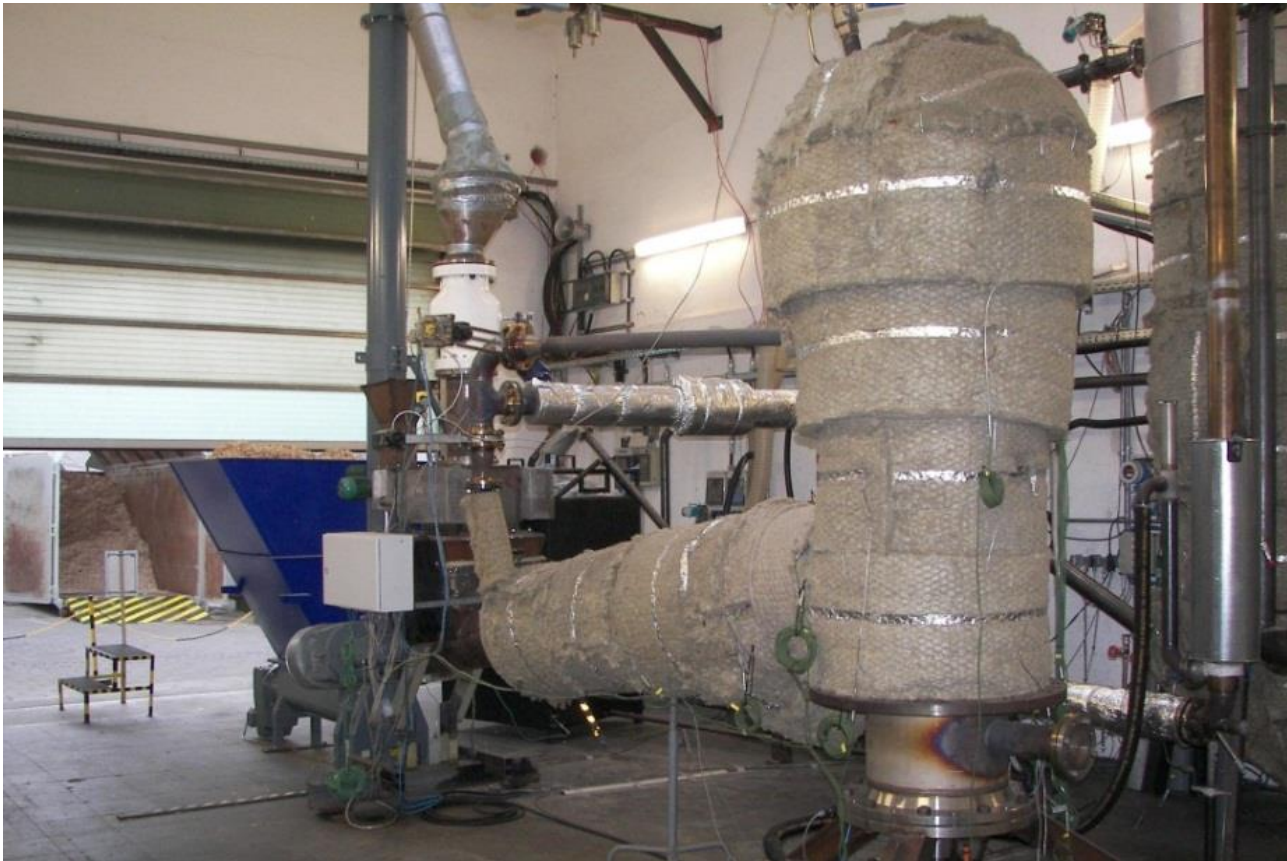
Abbildung 7.3 Versuchsanlage der Stadtwerke Rosenheim (© SWRO).
