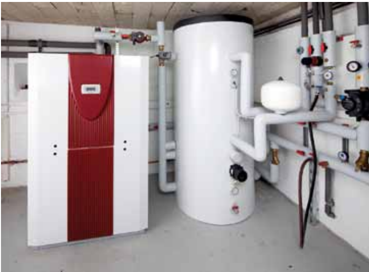
Blick in einen modernen Heizungskeller mit Wärmepumpe: Wer seine Heizung Schritt für Schritt modernisieren möchte, kann zum Beispiel einen bestehenden Öl- oder Gasheizkessel für Spitzenlasten nutzen und ansonsten eine Wärmepumpe zur Hauptversorgung einsetzen
