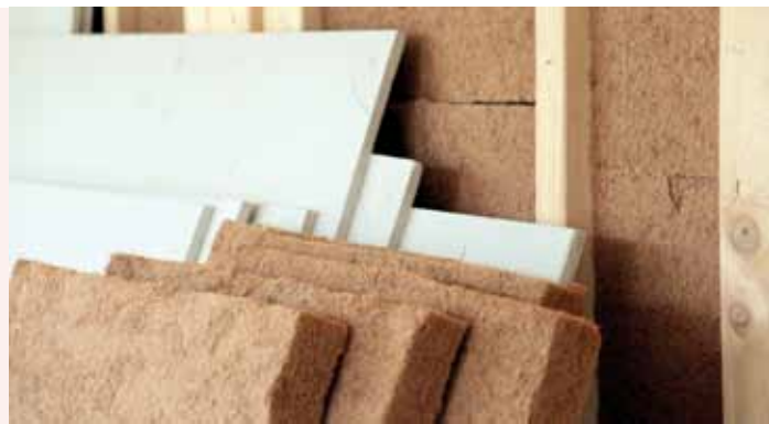
Innenwand eines Hauses in Holzständerbauweise, Gipsfaserplatten zum Verkleiden der Wände und Dämmplatten zur Wärmedämmung.
