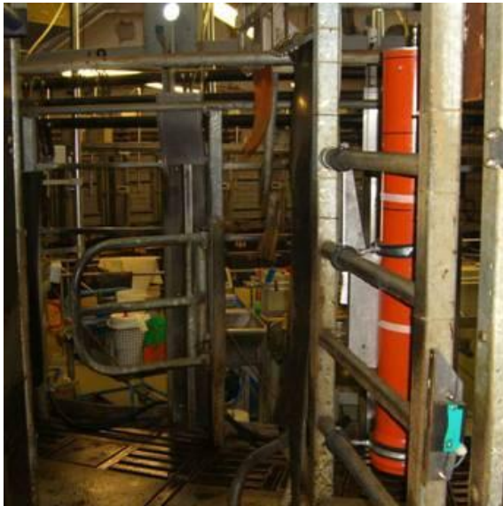
Abbildung 26: Innenleben Antennenrohr mit zwei Antennen und ASI-Reader
