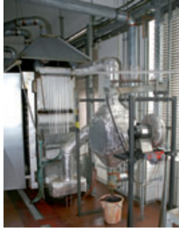
Um Abwärme zurückzugewinnen, installierte das Unternehmen aus Großröhrsdorf Kreuzwärmetauscher an den Trockenschränken.
