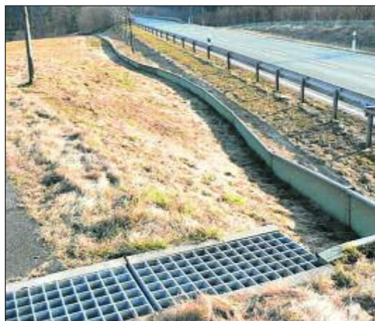
Amphibienschutzanlage an der S 282 A in Schönfels
