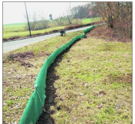
Mobile Amphibienschutzanlage an der Schachtstraße in Reinsdorf
