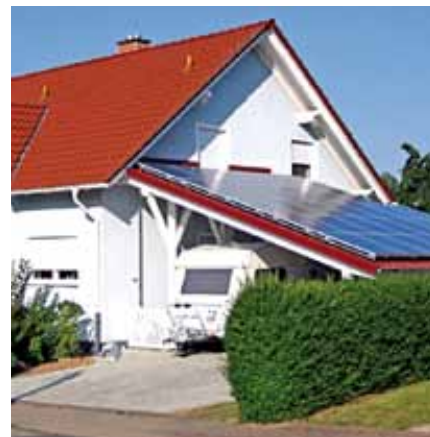
5,94 kWp Solaranlage der Kirchner Solar Group
