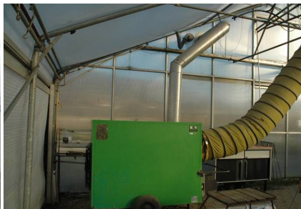
Abbildung 6: Heizung Remco CLA 100 mit Gas
