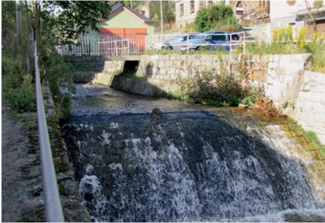
Das 2,2 Meter hohe Wehr an der Schlema in Schneeberg war eine unüberwindliche Barriere für wandernde Fische.
