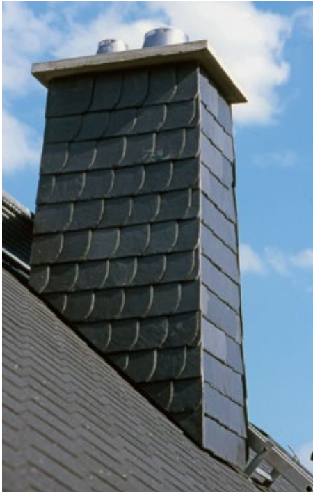
Schieferverkleidete Schornsteine werden gern von der Nordfledermaus als Quartier genutzt. Foto: Elke und Reimund Francke
