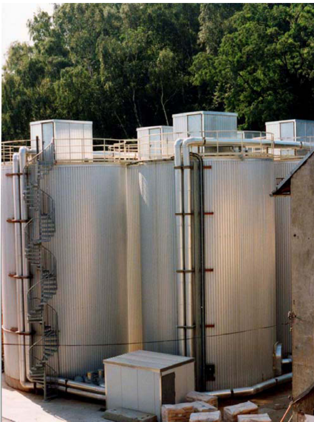
Abb. 79: Vorratsbehälter (Bütten) für Kaolinsuspensionen in Kemmlitz
