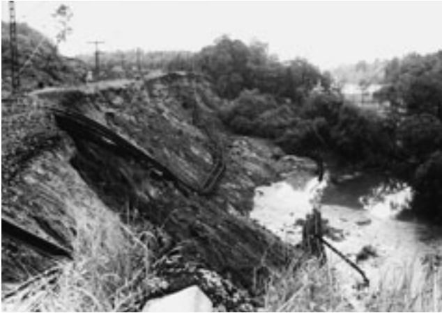
Abb. 2-3-4: Rutschung im Bereich der Kohleverbindungsbahn Ostausfahrt Tagebau Böhlen vom 16.06.1982
