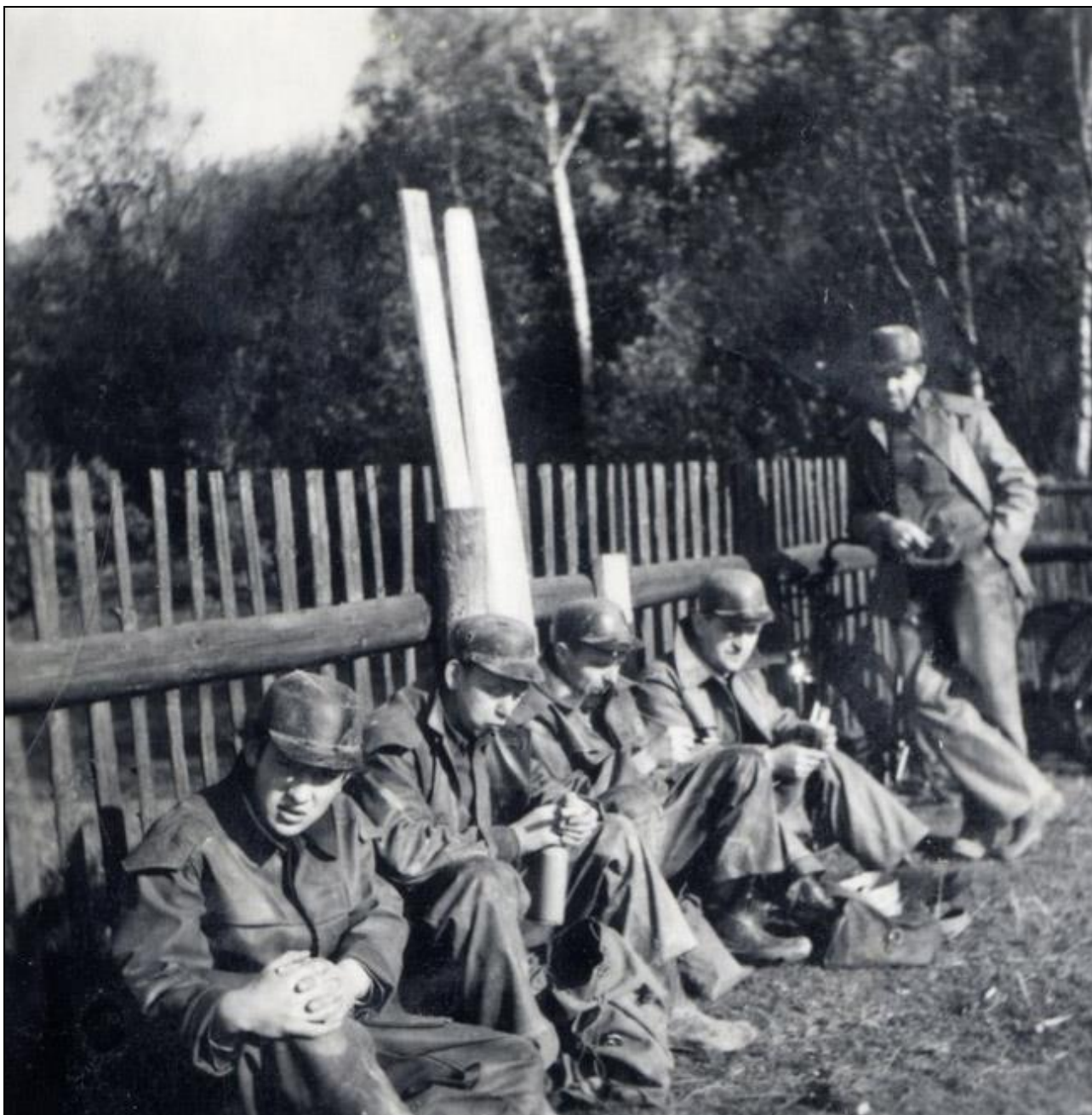
Während der Sanierung des „Weiße Rose Schachtes“ im Rahmen des „18-Punkte-Hochwasserschutzprogrammes“ von 1955. Foto: R. Klanthe
