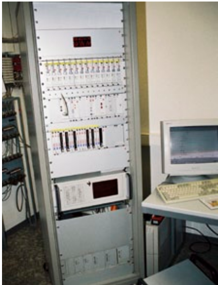
Abb. 22: Seismische Überwachungsanlage 3, Hauptanlage Schacht 371
