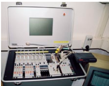
Abb. 23: Seismische Überwachungsanlage 3, Teilanlage Oberschlema
