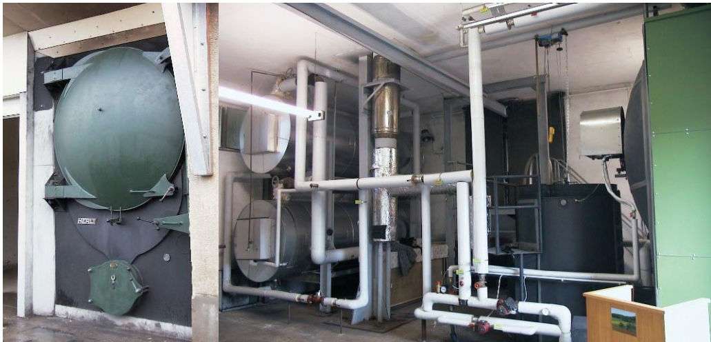
Abb. 36: Strohballenvergaser HSV 145 und Vergaserraum mit Wärmetauschern in der Wiesenburger Land eG in Wildenfels
