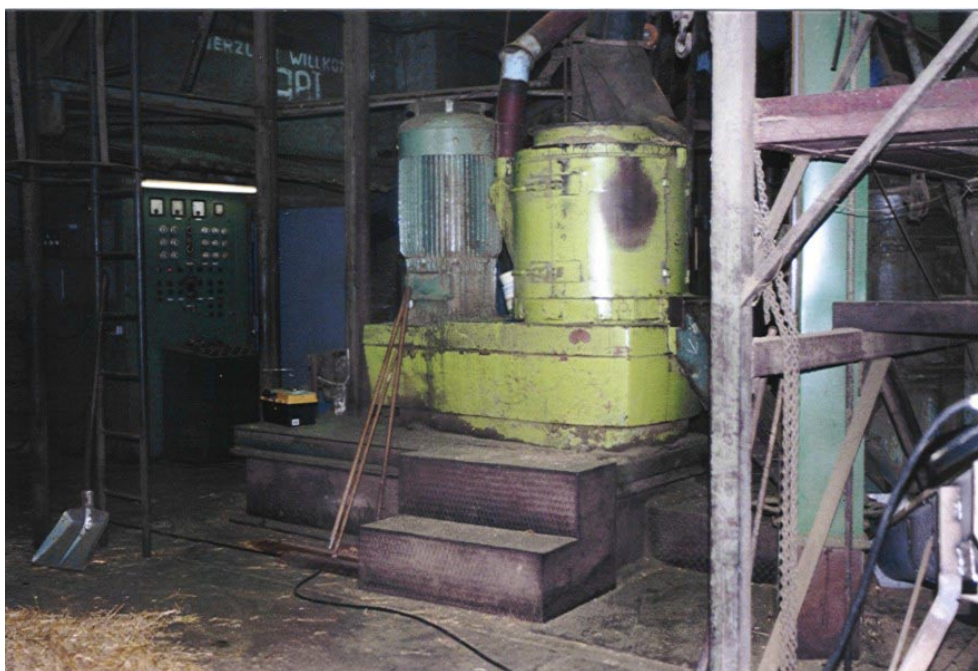
Abb. 26: Kollergang-Pressen (rechts) mit Elektromotor (Mitte) und Schaltzentrale (Landwirtschaftliche Trocknungs- und Dienstleistungs-GmbH Grimma)
