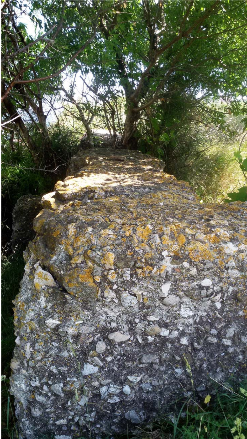
Fig. 12 - Tortoreto, località Colle Fontanelle, vasca di accumulo
