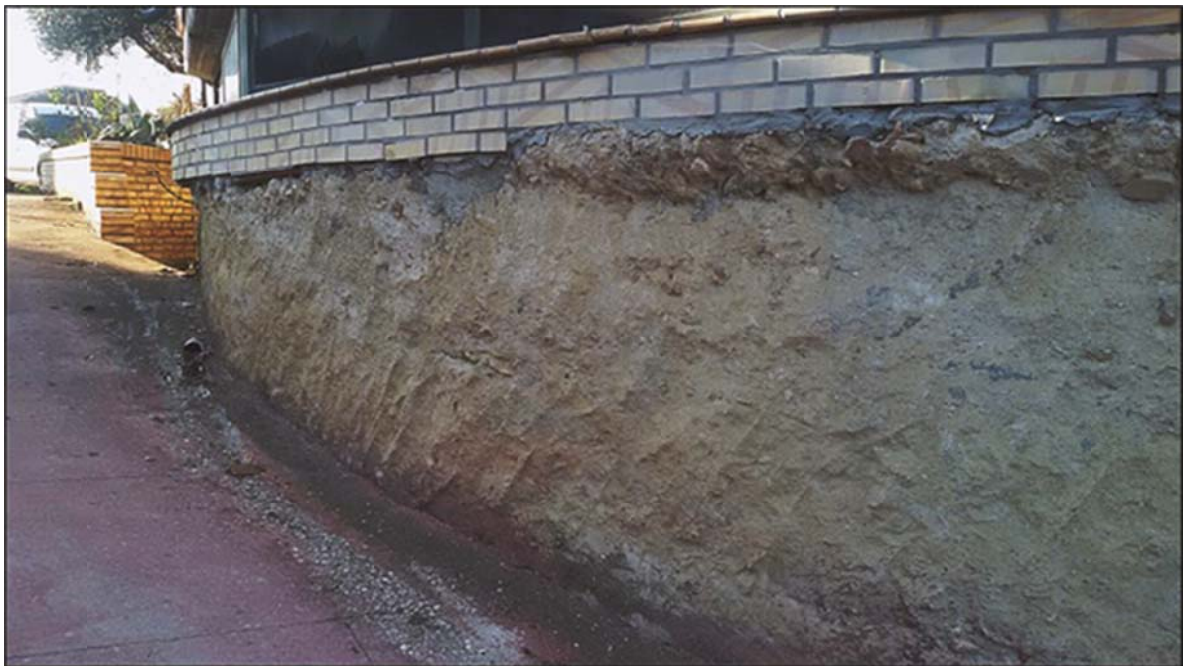
Fig. 27 - S. Omero, Cisterna De Bartolomeis, particolare del lato contro terra dopo la rimozione del terreno
