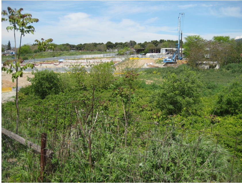
Εικόνα 7. Έργα κατασκευής σταθμού του μετρό στη Νέα Ελβετία, στην έκταση της πρώην λίμνης του χειμάρρου Αλλατίνη/Ντεπώ, όπου φυόταν πυκνή βλάστηση. Άποψη από το προαύλιο του ναού Αγίου Βασιλείου (φωτογραφία: Γ. Μπλιώνης, Απρίλιος 2015).
