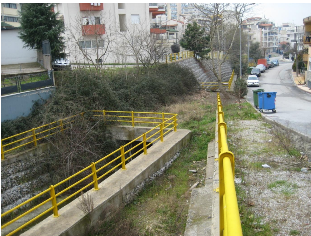
Εικόνα 6. Εγκιβωτισμός της κοίτης με συρματοκιβώτια και σχεδόν κάθετη κλίση πρανούς στην οδό Κρυονερίου, στις Συκιές (φωτογραφία: Γ. Μπλιώνης, Φεβρουάριος 2015).
