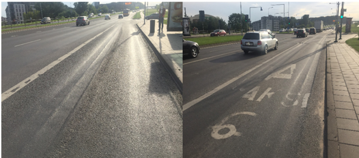
1.2 pav. Provėžų susidarymo asfalto dangoje pavyzdys Fig. 1.2. Example of rutting in the asphalt pavement
