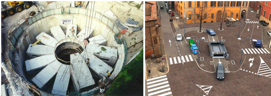
1.3 pav. Automatizuota požeminė automobilių stovėjimo aikštelė Bolonijos senamiestyje (Italija), kairėje – aikštelės statyba, dešinėje – veikianti požeminė aikštelė (nuotrauka: „Trevipark“)
