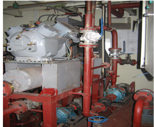
Gráfico 1. Chiller marino del sistema de aire acondicionado
