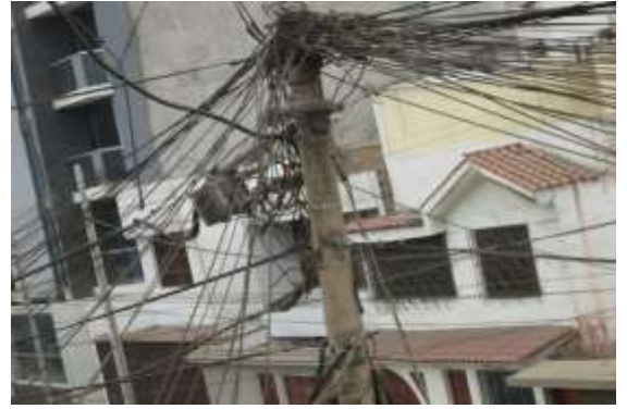
Acumulacion de cables de telefono en los postes
