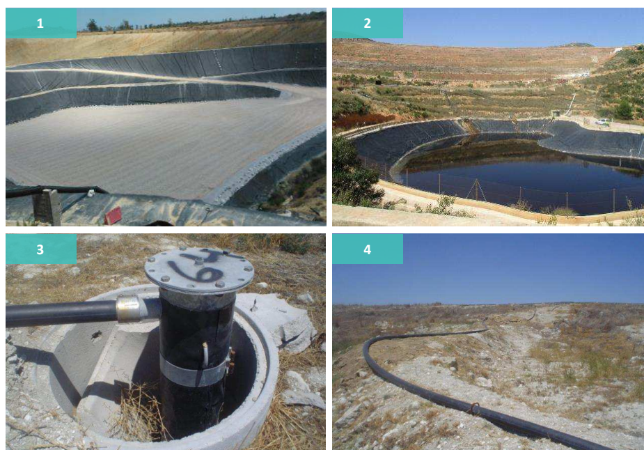
Figura 2.16 Vaso de vertido impermeabilizado (1), balsa para la recogida de lixiviados (2), chimenea para la extracción del biogás (3) y canalización de biogás (4)
