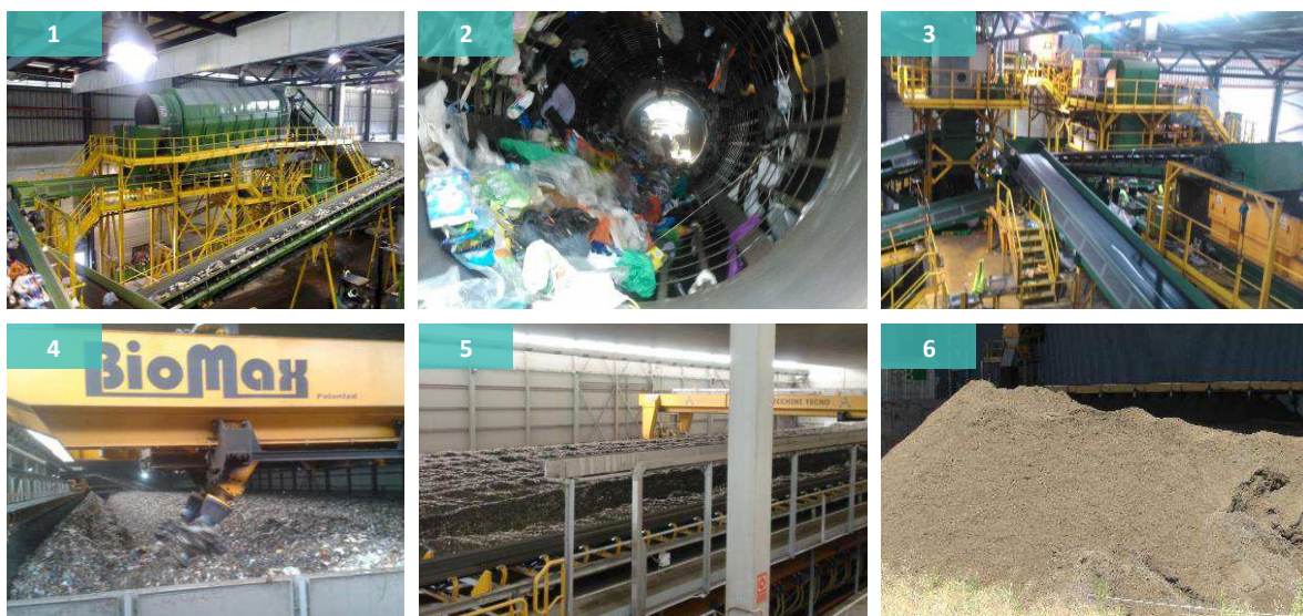
Figura 2.14 Recuperación mecánica de materiales: trómel (1 y 2) equipos de separación (3); Compostaje de la fracción orgánica: reactor de fermentación (4), reactor de maduración (5) y compost (6)
