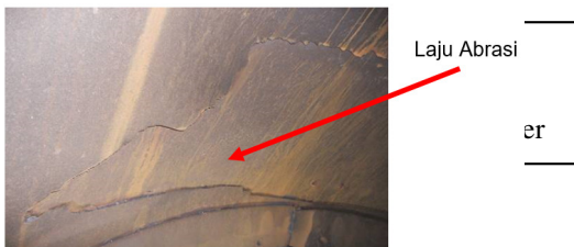
Gambar 6. Kondisi Abrasi Plate Liner Eksisting
