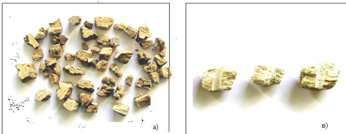
а) отложения в котловых трубах d = 51 \text{ мм} ;
