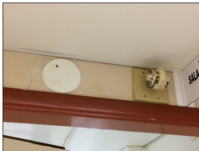
Figura 12: Instalação elétrica sem a luz vermelha de sinalização indicando que raios X estão sendo emitidos.
