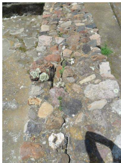
Fig. 5.42 Grieta en los muros divisorios de las habitaciones 30 y 32.
