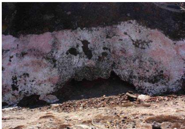
Fig. 5.63 Disgregación del núcleo y oquedad del
