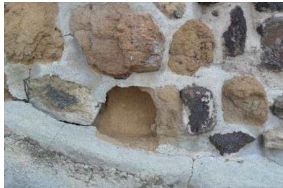
Fig. 5.57 Erosión de una piedra de tepetate del muro de mampostería.
