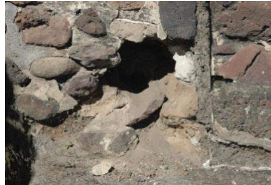
Fig. 5.56 Erosión de una piedra de tepetate del muro de mampostería.
