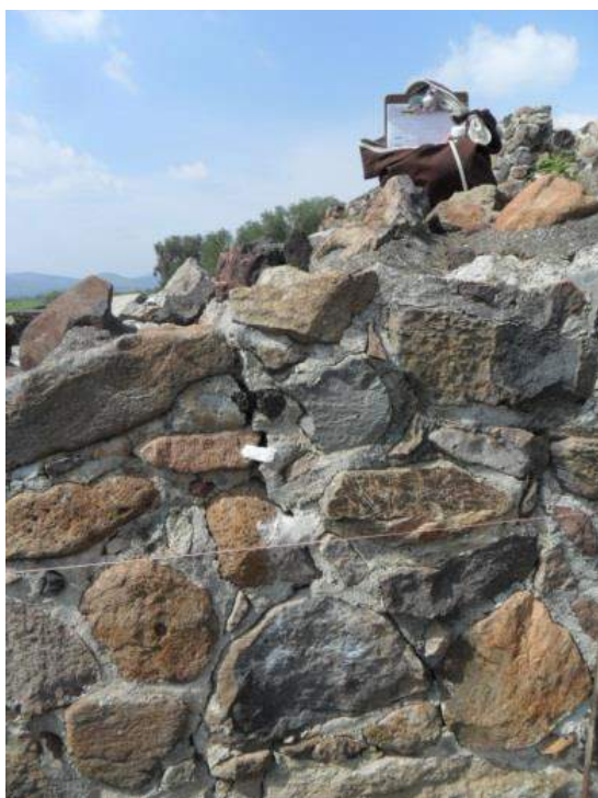
Fig. 5.39 Grieta en el basamento 40A.
