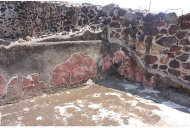
Fig. 2.31. Existencia parcial de enlucido pintado sobre aplanado.
