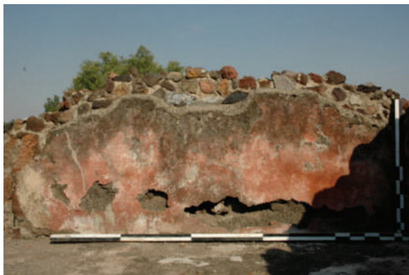
Fig. 5.14. Disgregación del núcleo, oquedad del aplanado y desprendimiento del enlucido.
