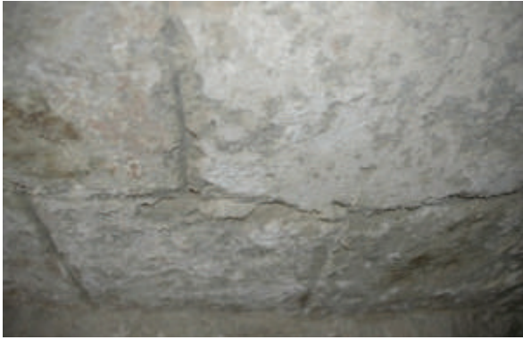
Fig. 5.26. Detalle de la alfarda que muestra concreciones salinas.
