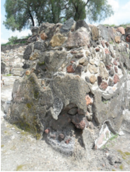
Fig. 5.16. Disgregación del núcleo y pérdida del aplanado.
