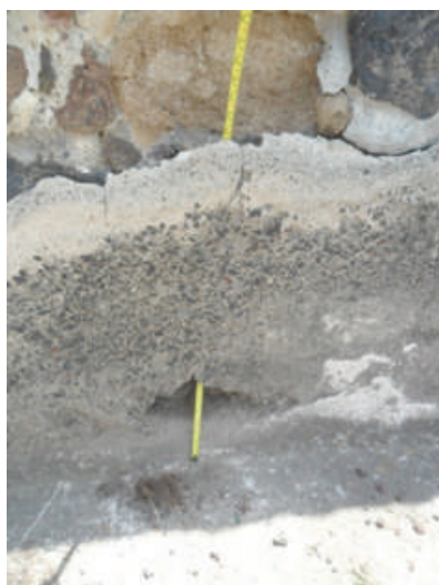
Fig. 6.1. Detalle de separación de aplanado con respecto al muro de mampostería.
