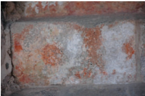
Fig. 5.28. Sillar estucado de la escalinata este con eflorescencias salinas.
