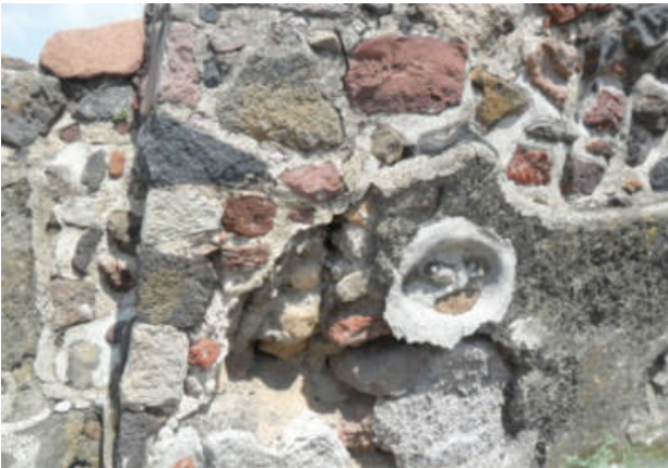
Fig. 5.18. Disgregación del núcleo y material de rejunteo y pérdida del aplanado.
