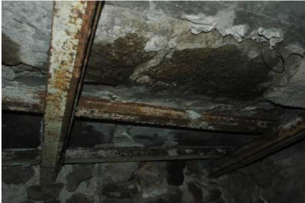
Fig. 5.51. Humedad al interior de la cubierta de la ventana arqueológica y oxidación de los perfiles.
