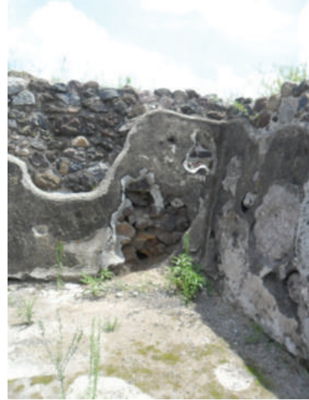
Fig. 5.17. Disgregación del núcleo y pérdida del aplanado.
