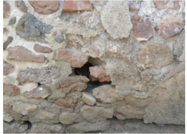
Fig. 5.9. Disgregación del material de rejunto en el muro de mampostería.
