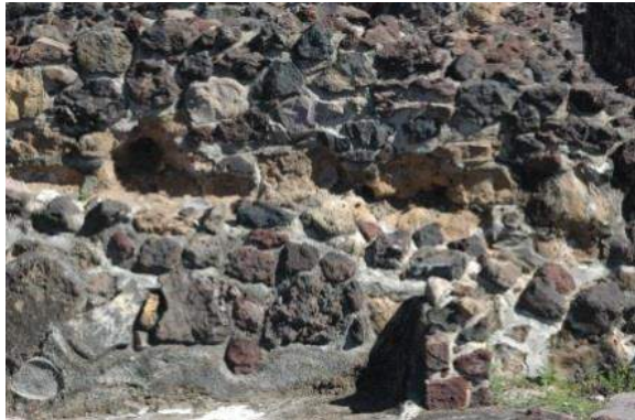
Fig. 5.55. Erosión de muro de mampostería.
