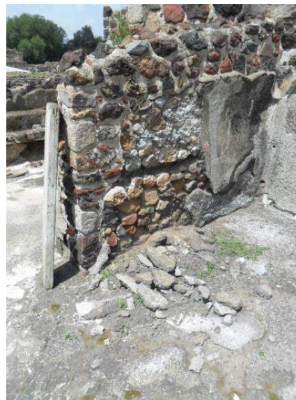
Fig. 5.65 Perdida de aplanado.
