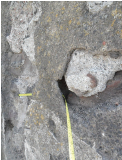
Fig. 5.10. Oquedades y desprendimiento en aplanado.
