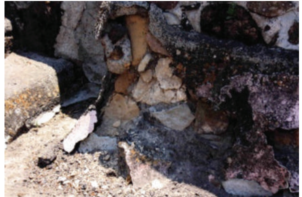
Fig. 5.13. Disgregación del núcleo y oquedad del aplanado.
