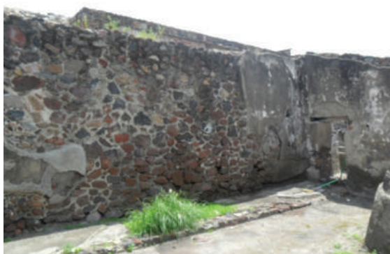
Fig. 5.20. Fachada sur del Basamento 40A, que a su vez delimita el patio 13. El muro presenta desprendimiento de aplanado.
