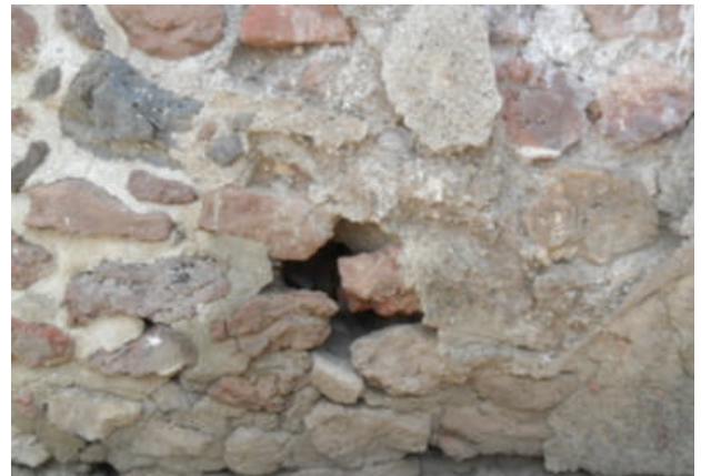
Fig. 5.19. Disgregación del núcleo y material de rejunteo y oquedad en el muro de mampostería.
