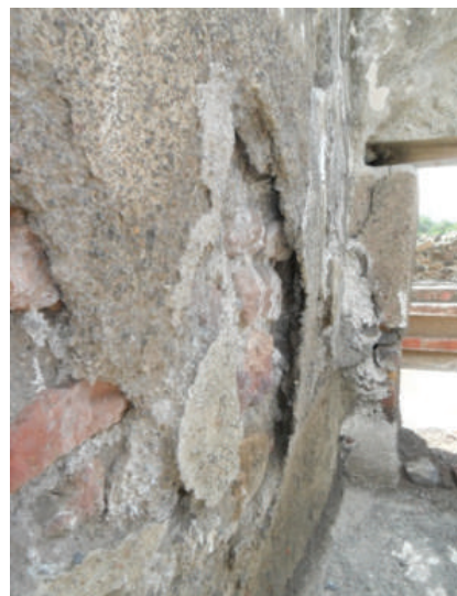
Fig. 5.21. Detalle del desprendimiento del aplanado de la fachada norte del basamento 40A.
