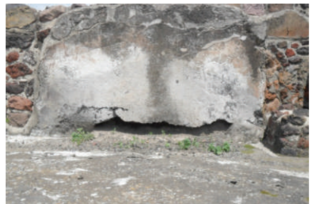
Fig. 5.15. Disgregación del núcleo, oquedad del aplanado y desprendimiento del enlucido.
