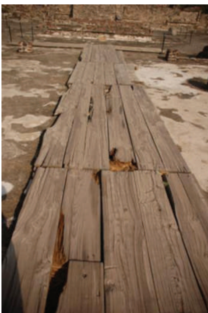
Fig. 3.43. Corredor de madera deteriorado antes de 2007. Archivo Departamento de Conservación y Restauración ZMAT.
