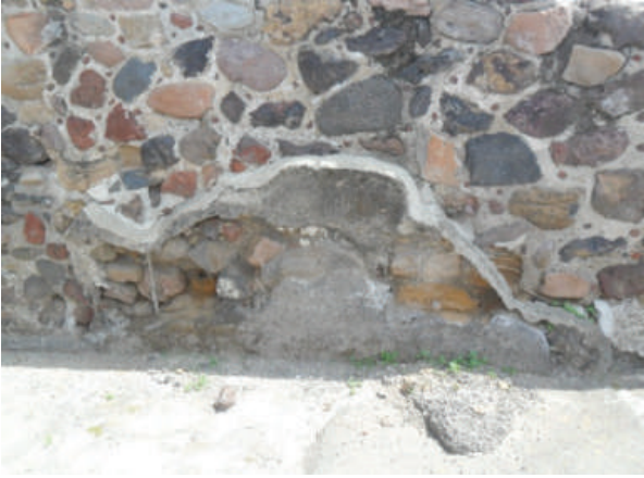
Fig. 5.8. Disgregación de aplanado hasta desaparecer y dejar la evidencia del ribete de cemento.
