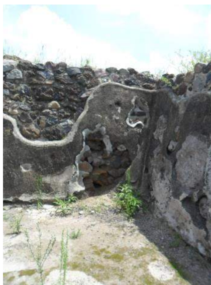
Fig. 5.60. Oquedades en muro causadas por madrigueras de techalotes.
