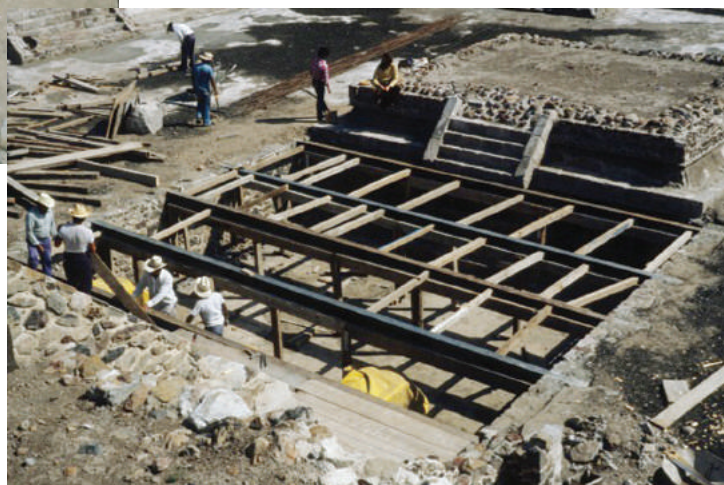
Fig. 3.40. Colocación de perfiles de acero 1-PR/8, para cubrir la ventana arqueológica. Fototeca CET-ZMAT.
