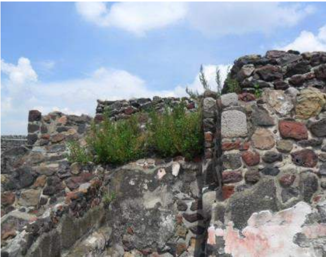
Fig. 5.32. Crecimiento de plantas superiores en mampostería.
