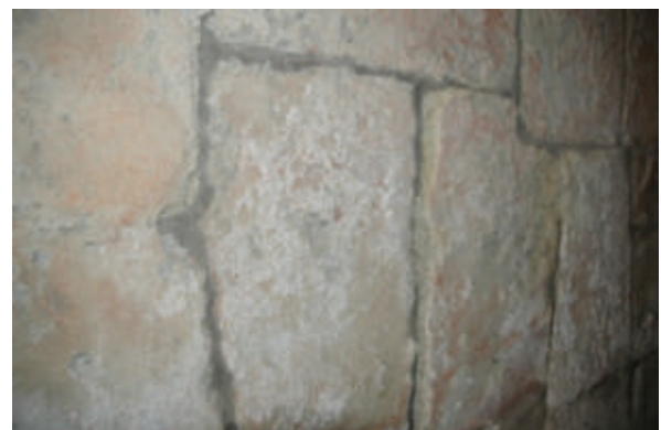
Fig. 5.25. Detalle de la alfarda que muestra concreciones salinas y juntas de cemento.
