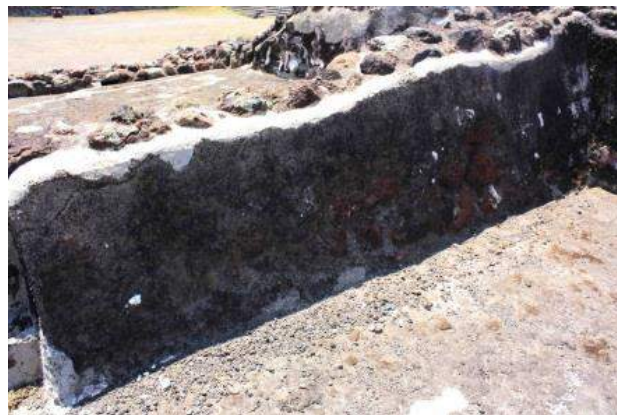
Fig. 5.36 Crecimiento de musgo en aplanado.
