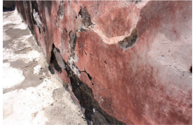
Fig. 2.32. Enlucido pintado con severo deterioro.
