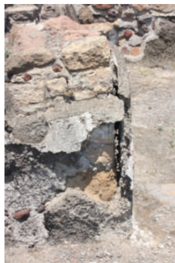
Fig. 6.2. Detalle de pilastra que muestra separación de aplanado con respecto al muro de mampostería. En ambos caso la filtración de agua de lluvia agrava el deterioro.
