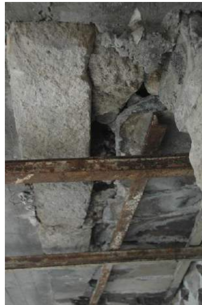
Fig. 5.52. Condiciones de la losa de concreto que muestra elementos pétreos fragmentados. Archivo DCR-ZMAT
