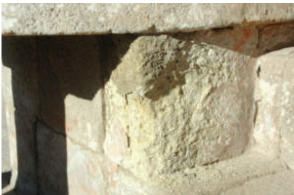
Fig. 5.24. Sillar de la escalinata oeste con sulfatación.
