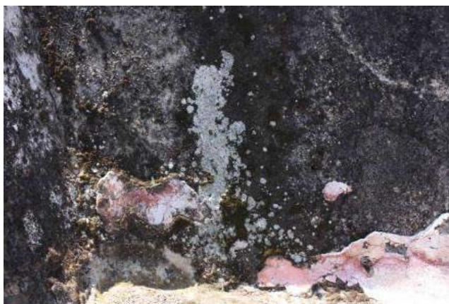
Fig. 5.37 Crecimiento de liquen y musgo en aplanado.
