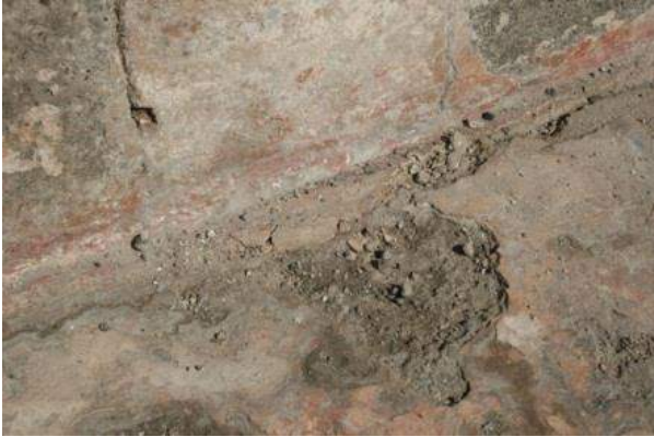
Fig. 5.46. Desprendimiento de enlucido de piso debido a la abrasión de las cortinas.
