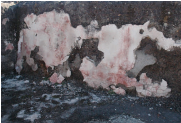
Fig. 5.12. Disgregación del núcleo y oquedad del aplanado.
