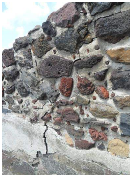
Fig. 5.40 Grieta en el basamento 40A.
