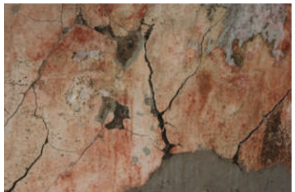
Fig. 5.29. Enlucido con grietas y fisuras.
