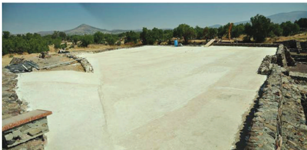
Fig. 3.49. Continuación para la colocación del firme de sacrificio en la temporada 2011. Archivo Departamento de Conservación y Restauración ZMAT.
