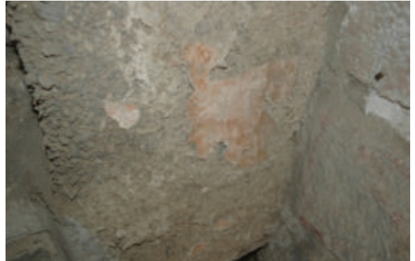
Fig. 5.27. Desprendimiento de enlucido en sillar y disgregación del material pétreo.
