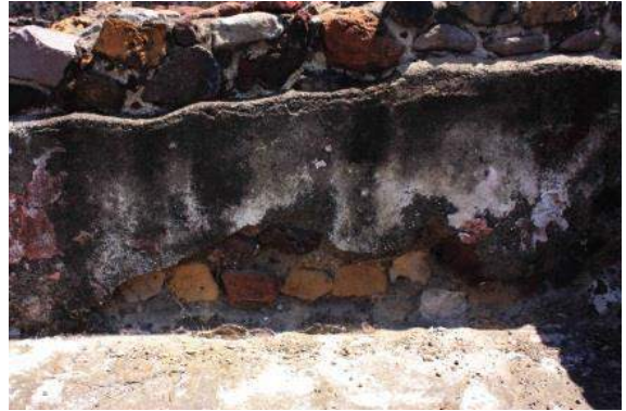
Fig. 5.35 Crecimiento de algas sobre aplanado.
