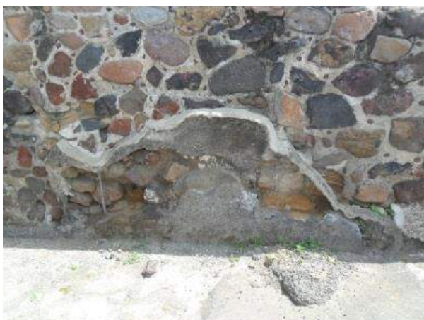
Fig. 5.64 Perdida de aplanado, sólo queda el ribete de cemento que evidencia que existió el aplanado.
