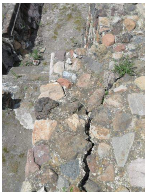
Fig. 5.41 Grieta en los muros divisorios de las habitaciones 19 y 22.
