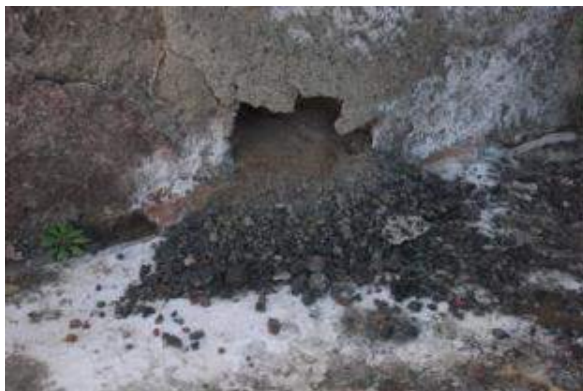
Fig. 5.62. Disgregación del núcleo y oquedad del aplanado.
