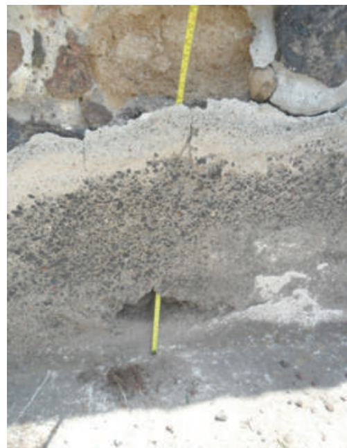
Fig. 5.11. Desprendimiento de aplanado.
