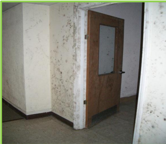
Figura 26. Moho creciendo en la superficie de paneles de yeso y remates pintados. La alta humedad por largo tiempo es la fuente de humedad que permite el enmohecimiento. Todos los muros tuvieron condiciones similares cercanas a la condensación.
