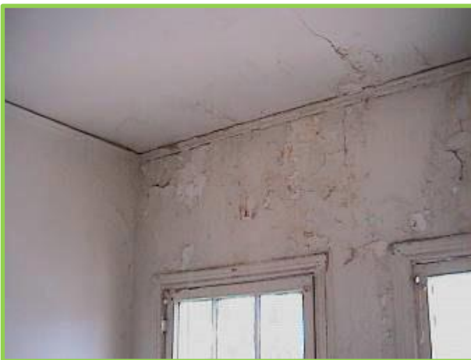
Figura 29. El agua de lluvia es introducida de este ensamblaje de ladrillos por acción capilar, y la humedad camina hacia abajo por la fuerza de gravedad. La pintura despegada contiene plomo y provoca un medio ambiente peligroso.
