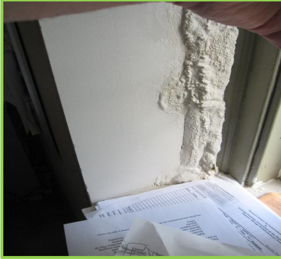
Figura 27. Otros daños por lluvia en el revoque interior. La filtración de la lluvia convierte el compuesto de la junta del panel de yeso en un fluido, causando que se formen burbujas en el yeso y que se levante.
