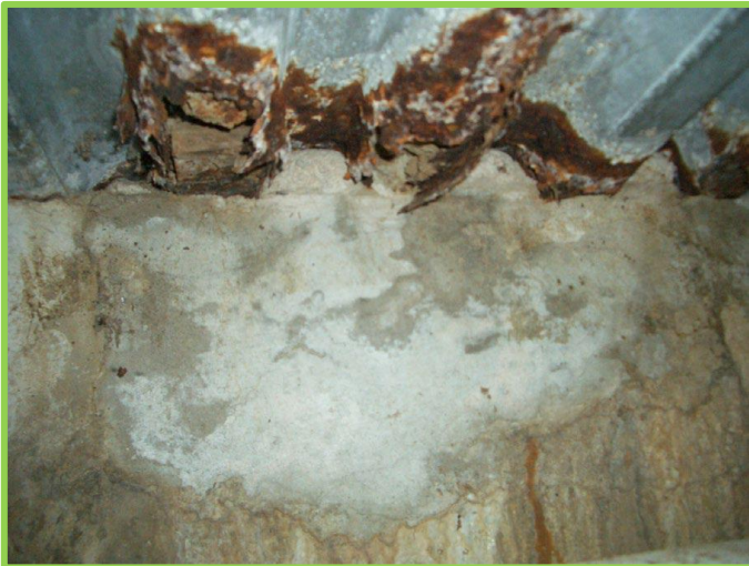
Figura 28. Corrosión en lámina de acero galvanizada acanalada. El agua proviene de la filtración de agua de lluvia.
