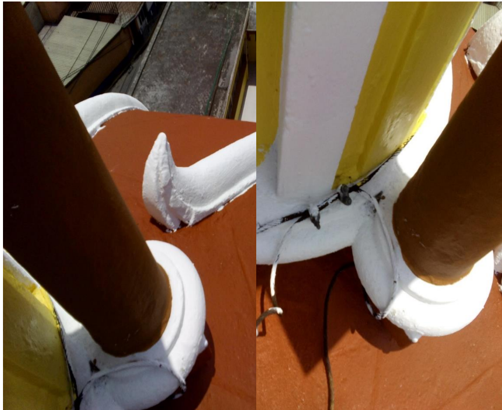
Deterioro en linternilla y tensor de acero
