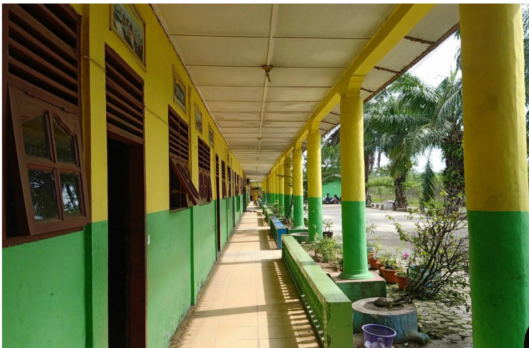
Gambar 1.4 Kondisi Teras MA Muhammadiyah 13 Sei Rampah
