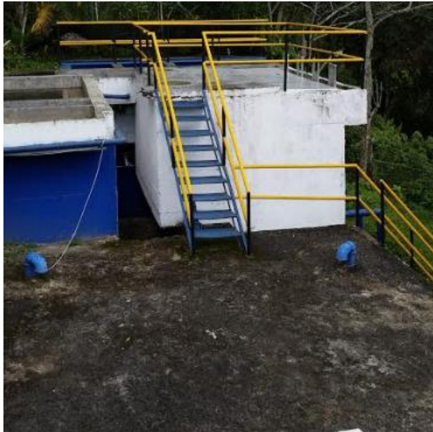
Imagen 40. Tanque con sus respectivos bastones de ventilación.
