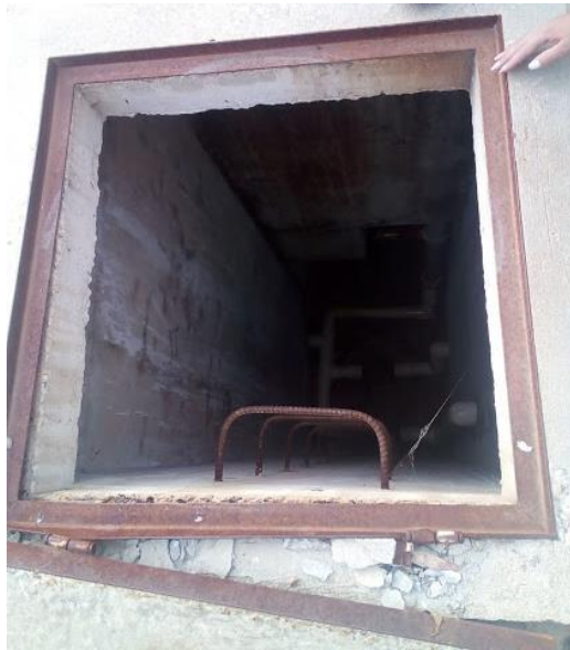
Ilustración 26 Tapas a válvulas de conexión con el tanque recolector
