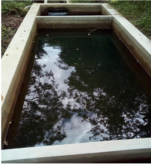
Ilustración 18 estructuras de captacion sedimentador completo
