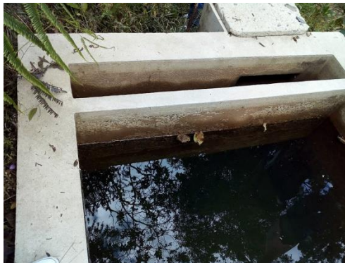
Ilustración 17 estructuras de captacion sedimentador
