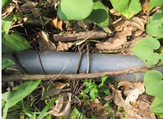
Ilustración 44. Tubería superficial "rio lindo"
