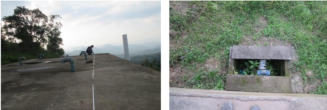
Ilustración 41. Tanque de almacenamiento.
