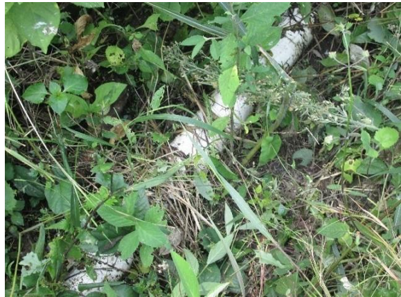
Ilustración 45. Tubería expuesta "río Lindo".
