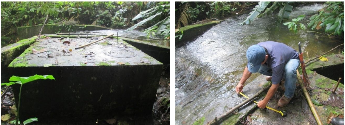
Ilustración 24. Cámara reguladora de caudal
