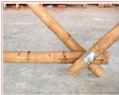
Figura 14 Falla en elementos de bambú por corte paralelo a las fibras.
