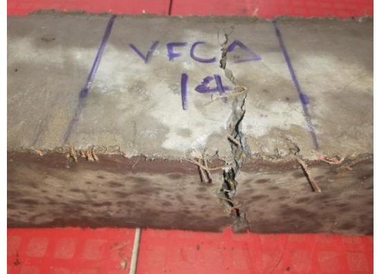
Figura 62. Viga de concreto reforzado con fibras de cáñamo después de ensayo a flexión. VFC1 - 14 días.
