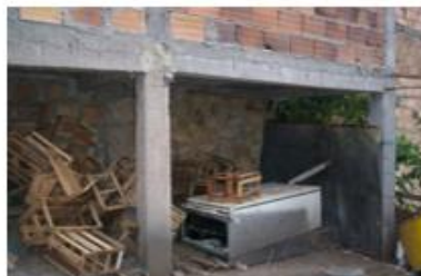
Ilustración 13: Malas Prácticas Constructivas
