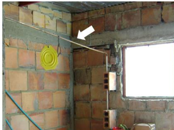
Ilustración 10 Malas Prácticas Constructivas.
