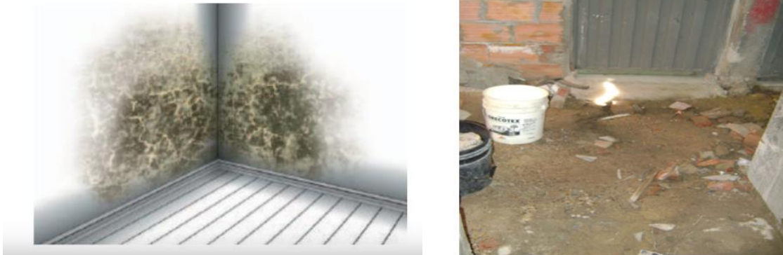
Ilustración 12 Malas Prácticas Constructivas
