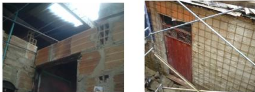
Ilustración 11: Malas Prácticas Constructivas
