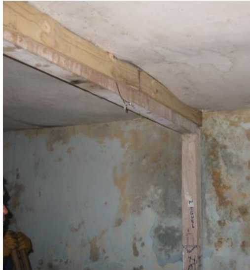
Ilustración 14 Malas Prácticas Constructivas
