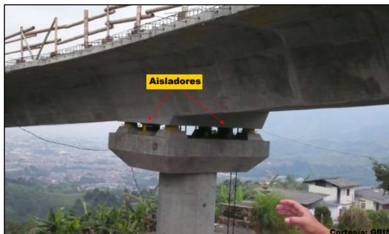
Figura 4. Aisladores en pila del Viaducto Helicoidal.
