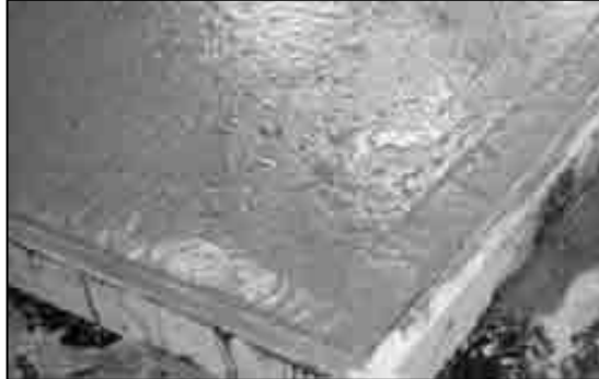
Figura 15. Exudación en superficie de concreto de una losa
