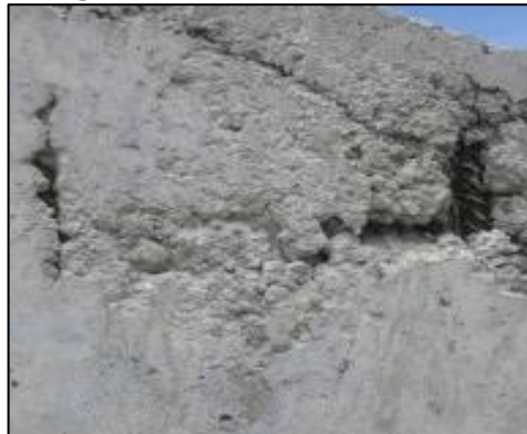
Figura 17. Exceso de Vibrado
