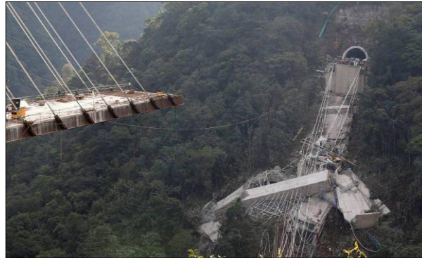
Figura 2. Falla en la Construcción Del Puente Chirajara
