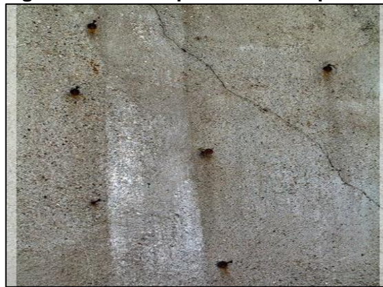
Figura 11. Fisura por retracción plástica
