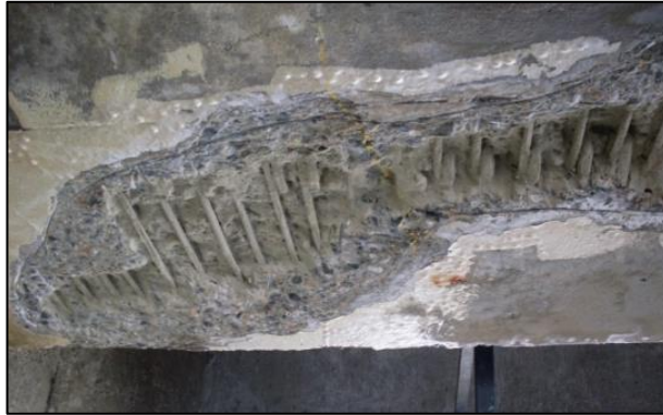
Figura 19. Segregación de la superficie de una viga
