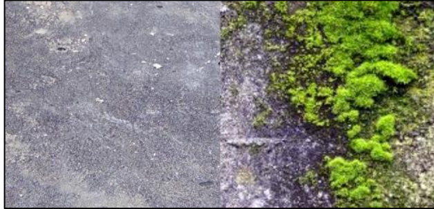
Figura 10. Moho y Musgo en Estructuras
