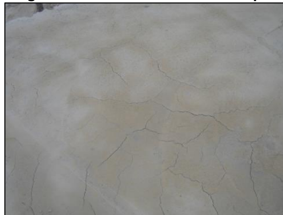
Figura 16. Fisuras en forma de Mapeo
