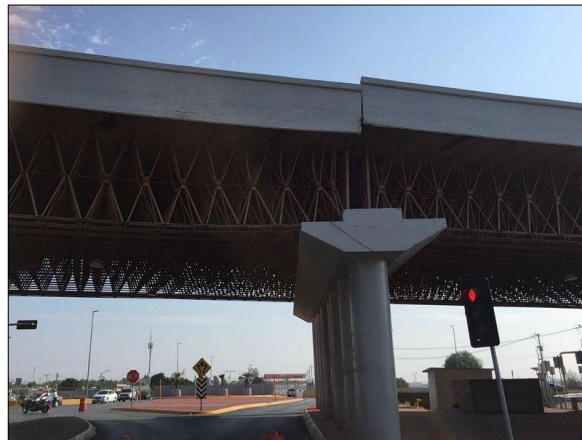
Figura 3. Falla en Junta de Dilatación en el Puente Villa Florida
