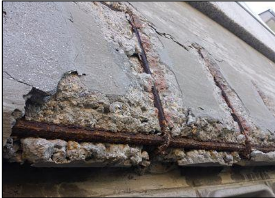
Figura 5. Estructura Expuesta a Corrosión
