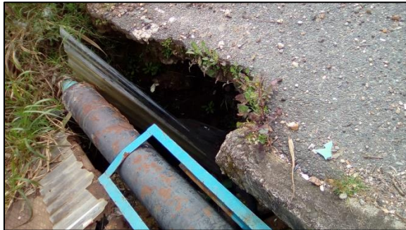
Figura 13. Estado del puente Pinares. Pérdida de capa de rueda. Fuente. Creación Propia
