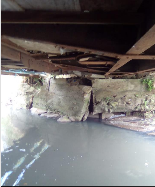
Figura 12. Estado del puente Pinares. Socavación del bastión. Fuente. Creación Propia
