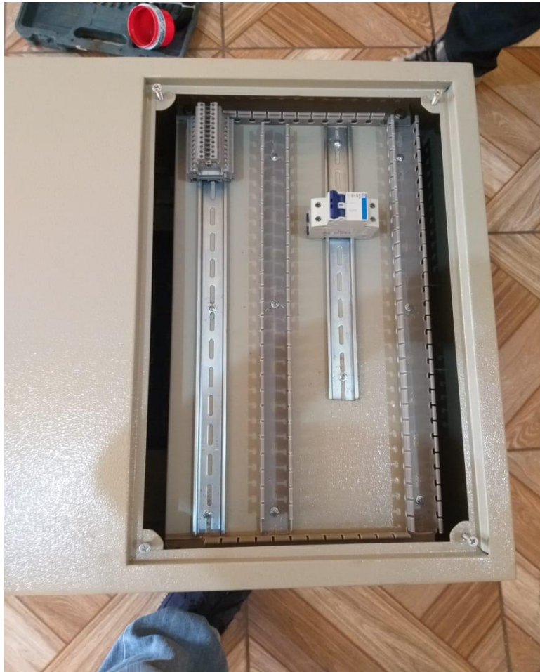
Anexo A 8: Panel de control
