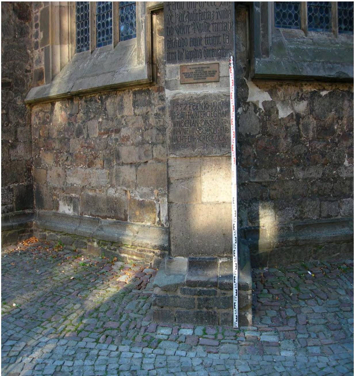
Abb. 34: Hochwassermarken an einem Pfeiler der St. Blasiuskirche in Hannoversch Münden (Foto A. Beyer, 2007) Am 24. Juli 1342 erreichte das Hochwasser die untere Kante des oberen Quadersteins
