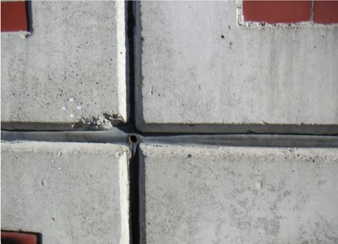
Kuva 4.10 Betonielementtien välisiä elastisia kittisaumoja. Saumojen taustatilan tuuletus ja vedenpoisto on järjestetty ns. tuuletusputkien avulla.
